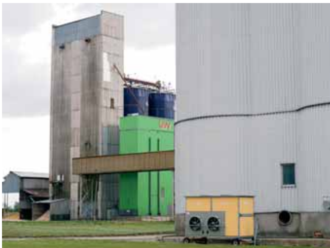
V popredí na zemi zariadenie GRANIFRIGOR KK 280 AHY s centrálnym rozvodom, ktoré bolo experimentálne nainštalované kvôli potrebe chladenia bloku ocelových síl pri skladovaní sladovníckeho jačmeňa, naľavo od síla je pozberová linka so sušičkou LAW a spojovací mostík so sílom.
