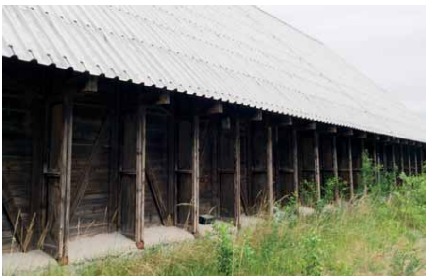
PROMOS sklady s typickými drevenými opornými roštami na vonkajšej strane a s krytinou z vlnitého plechu sa stavali v druhej polovici 70. rokov.
