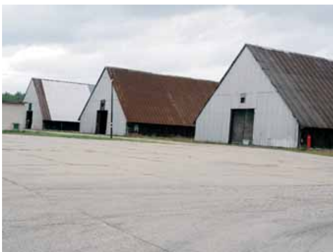
Čelné časti troch hangárových skladov systému PROMOS v Marcelovej sa v súčasnosti využívajú na skladovanie voľne ložených obilnín.
